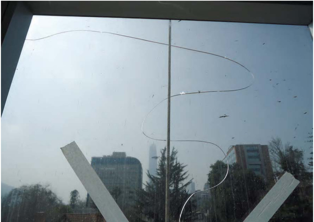
Fractura por estrés térmico.
